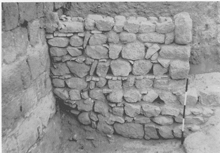
Fig. 11 : Un des murs adossés à la muraille, apparu dans les fouilles de la porte ouest.
